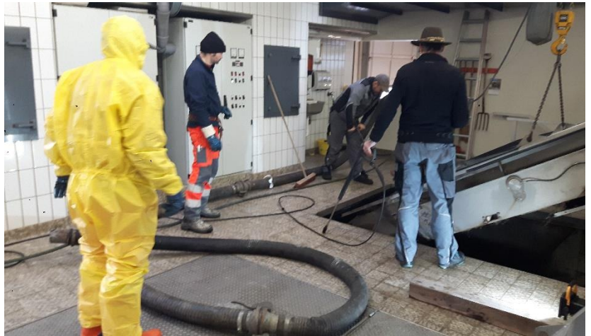
Sandablagerungen hinter Feinstrechen absaugen
